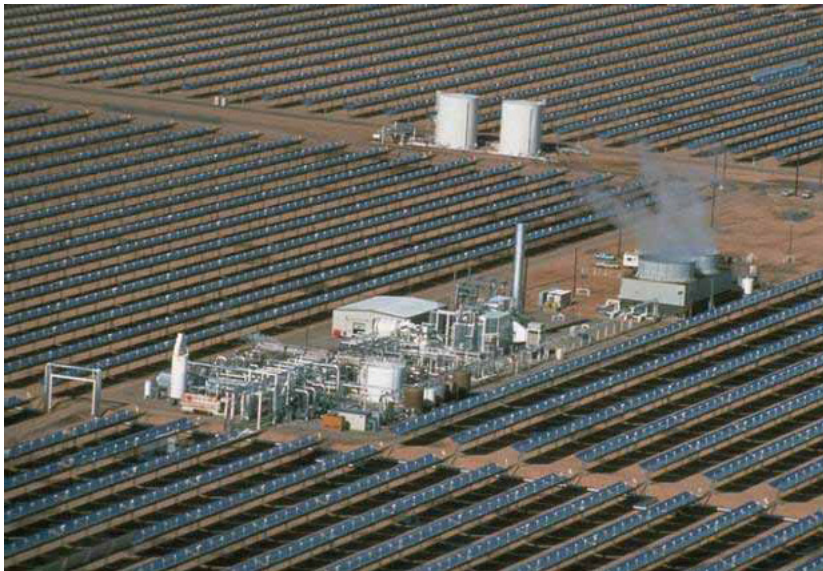
Figuur 2-3 Stoomturbine en rijen met troggen van de SEGS parabolische trogcentrale bij Kramer Junction, VS.
