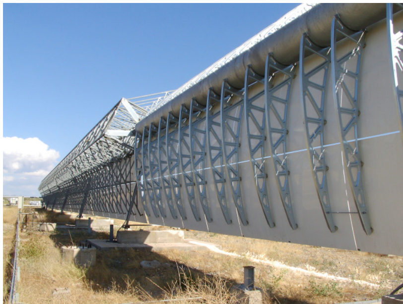
Figuur 2-5 Voorbeeld van twee typen ondersteuningsconstructies voor troggen op het Plataforma Solar.
