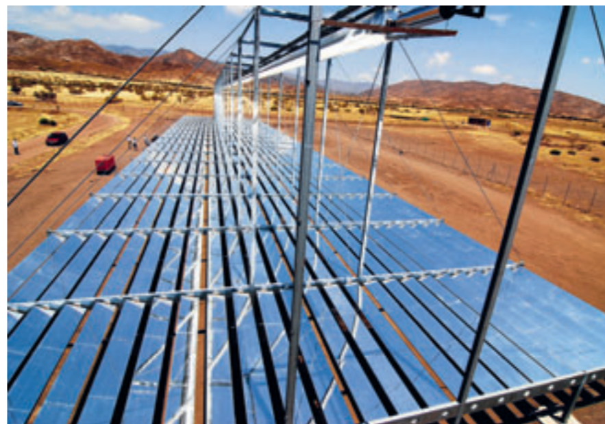
Een installatie met vlakke Fresnelspiegels in het Spaanse Almería.
